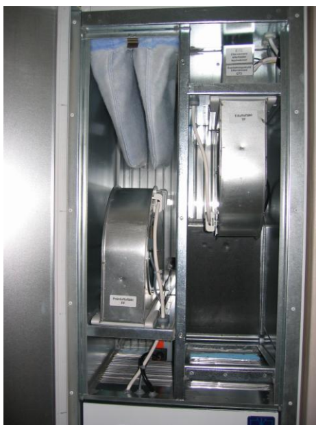
Figur 4.1 Lägenhetsbaserat FTX-aggregat i Brogården med fläktar, filter och värmeväxlare.
