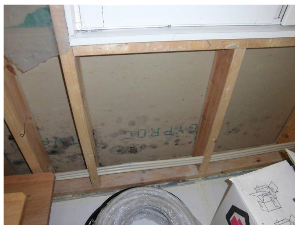
Figur 9. Mögelpåväxt på utvändig gipsskiva
