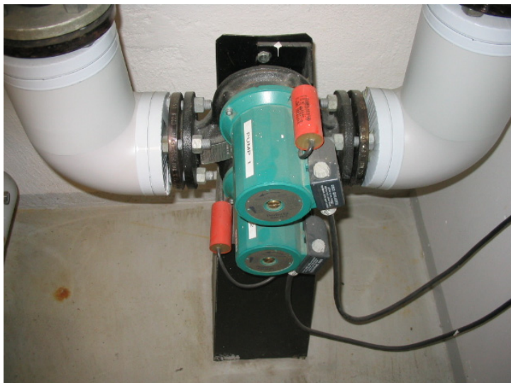
Figur 4.4 Vanligt förekommande installation av cirkulationspumpar.
