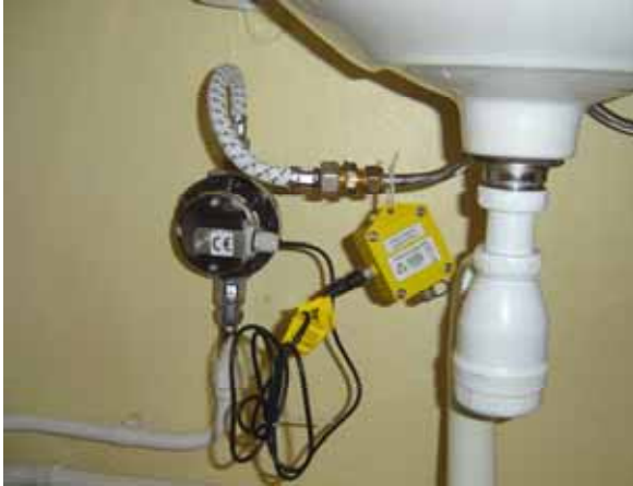
Figur 3. 1 En flödesmätare och logger monterade på varmvattenrör under ett tvättställ
