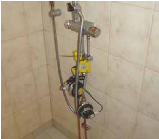
Figur 3. 3 Två flödesmätare med logger monterade på kall- och varmvattenrör i en dusch
