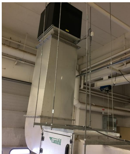
Figur 10 Slutfilter och avluftsfläkt
